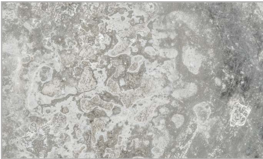
Mancha blanca sobre superficie galvanizada
