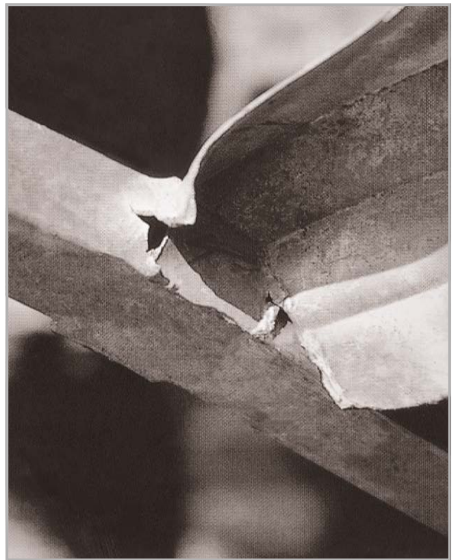
Explosión de un perfil tubular cerrado
